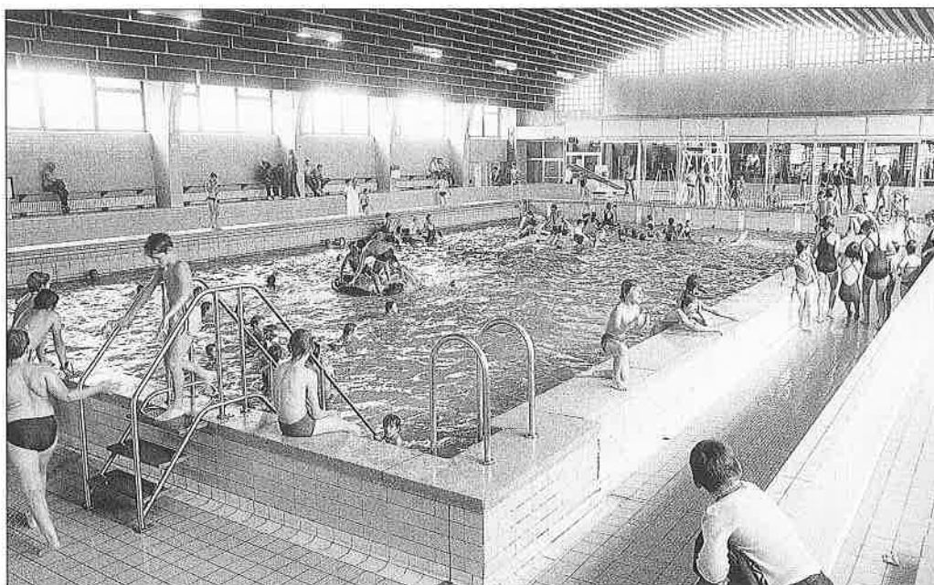
In 1988 werd een akoestisch plafond geplaatst dat wegens roestvorming enkele jaren nadien terug werd verwijderd. Let tevens op het opstaand zijmuurtje
